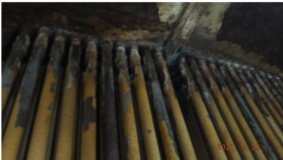
Dach komory czystej, dysze czyszczące
